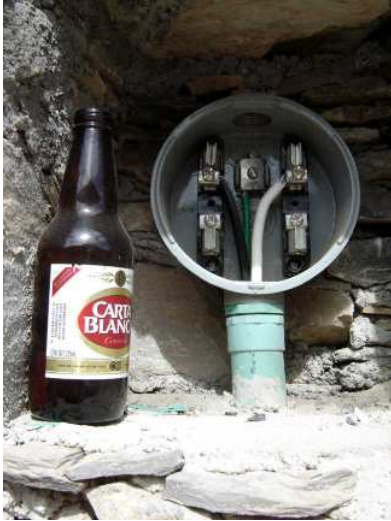
Une installation électrique
