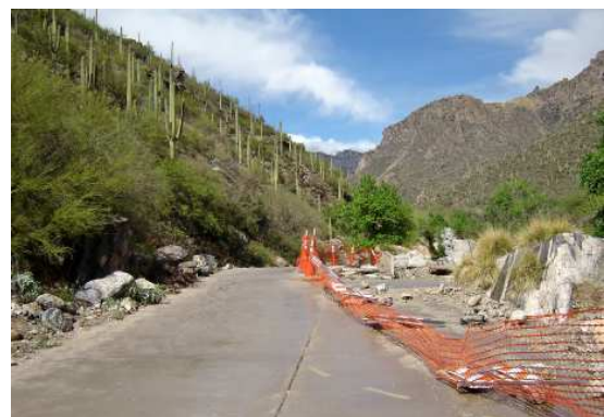
Un des glissements de terrain
